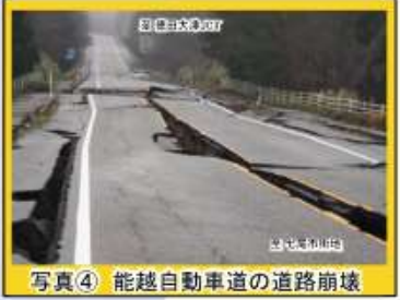
写真④ 能越自動車道の道路崩壊
