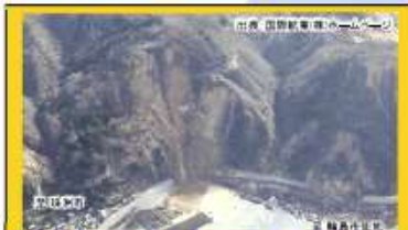
写真② 国道249号沿岸部の大規模土砂崩れ
