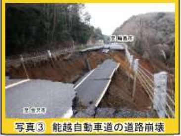
写真③ 能越自動車道の道路崩壊
