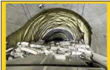
写真① 国道249号大谷トンネル内の崩落
